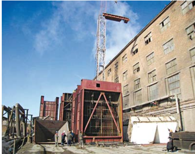
Только за последние два года завод вложил около 200 млн рублей в природоохранные мероприятия. На фото - установка нового фильтра.
